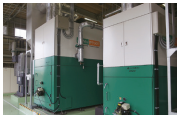
木質バイオマスボイラー
