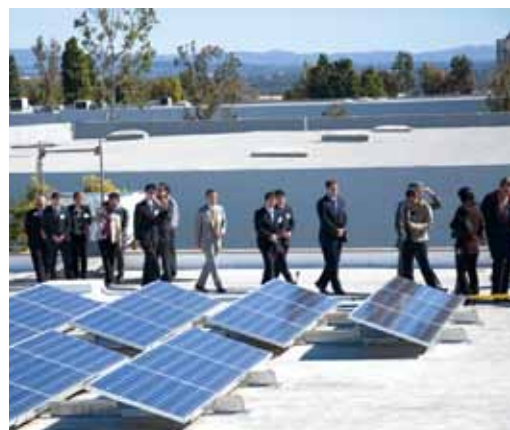
屋上に設置された太陽光発電システム
