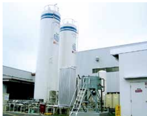
コージェネレーションシステムの外観。左が液化天然ガスタンク。右はガス発電エンジン建物
