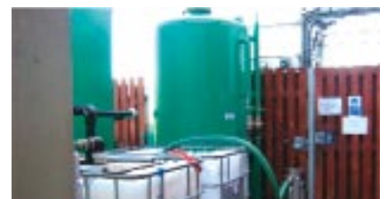
オイル除去装置
