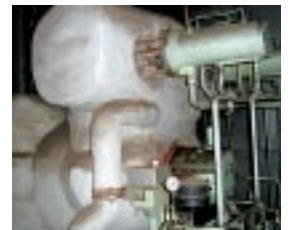
新しく切り替えられた設備
