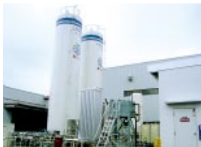
コージェネシステム外観。左が液化天然ガスタンク、右はガス発電エンジン建物
