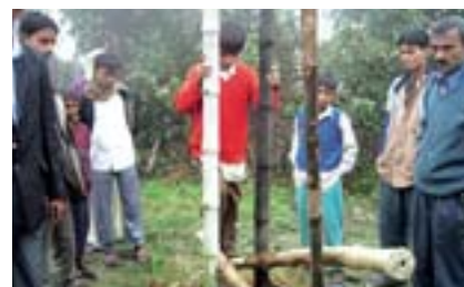
設置された足踏みポンプ
