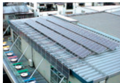
リコーユニテクノの太陽光発電システム
