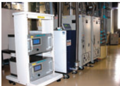
ポンプインバーターユニット
