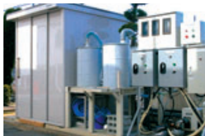
スーパーウェルポイント工法浄化装置(リコーエレメックス岡崎)
