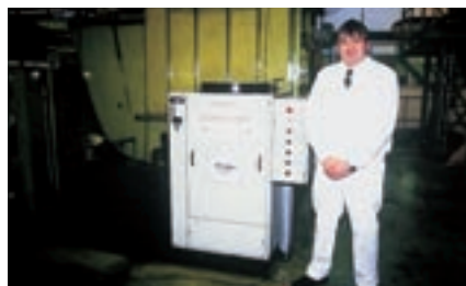
水のクローズドシステム(リコーUKプロダクツ)
