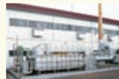
溶剤ガス直接燃焼装置
