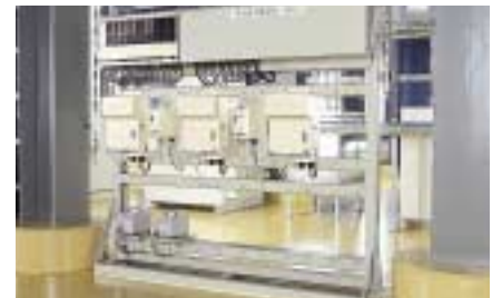
リコーやしる事業所のガスセンサーユニット。ガス漏れを検出するために、各種ガスに対する検出装置を設置。データを、コントロールルームで常時モニターしています。
