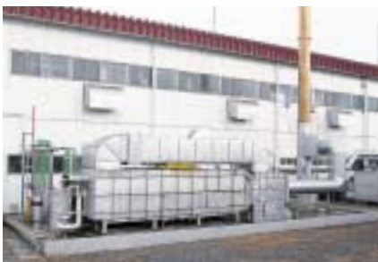
溶剤ガス直接燃焼装置
