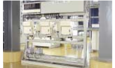
リコーやしる事業所のガスセンサーユニット。ガス漏れを検出するために、各種ガスに対する検出装置を設置。データを、コントロールルームで常時モニターしています。
