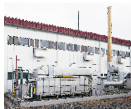
溶剤ガス直接燃焼装置
