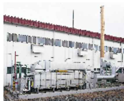
溶剤ガス直接燃焼装置
