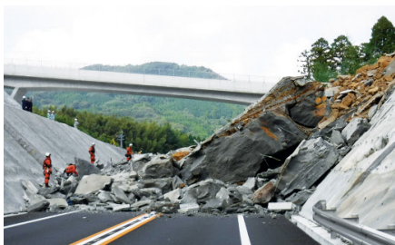
西九州自動車道で発生したのり面崩落事故【2018年10月】(出所) 国土交通省
