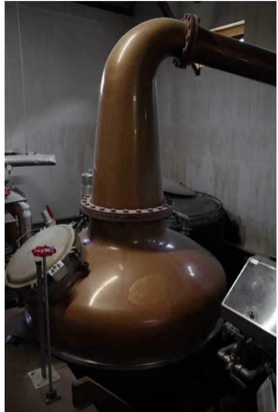
三宅製作所が製作した蒸溜設備 【4月20日、福島県郡山市】
