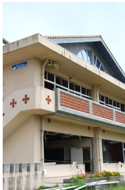
町立中浜小学校では「ブルー線」まで津波が押し寄せたが、児童全員が三角形の屋根裏部屋に無事避難
