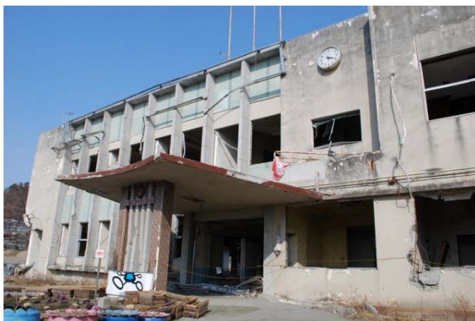
崩壊した大槌町役場旧庁舎が3.11を今に伝える
